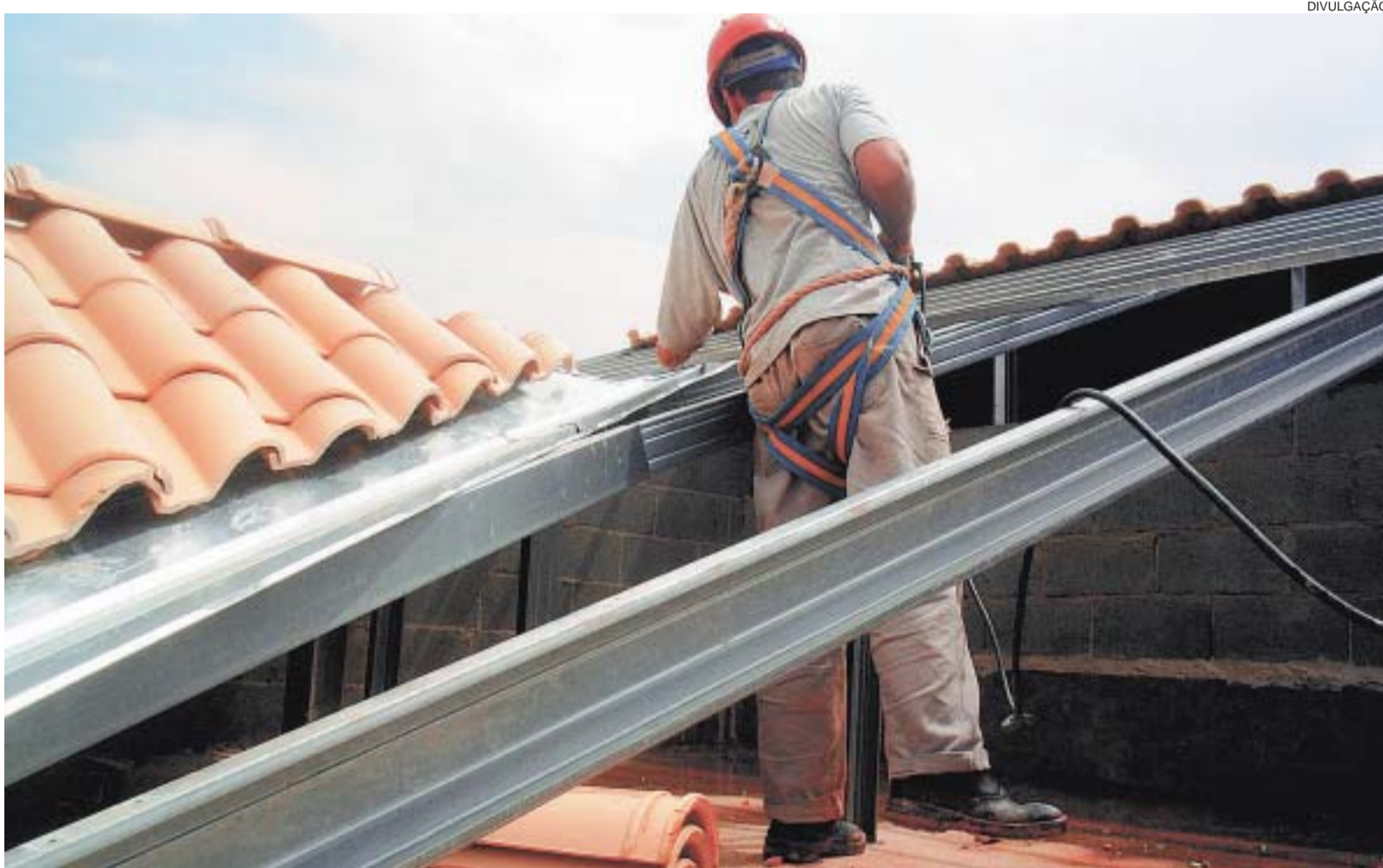
RAPIDEZ - Montagem da estrutura de aço para telhados é mais rápida, limpa e não provoca desperdícios
